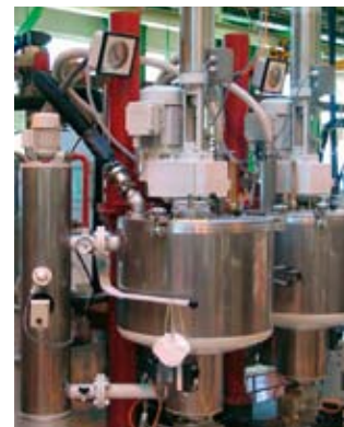
Рис. 5. Установка подготовки компаунда, завод ABB s.r.o. (Brno, Czech Republic)
